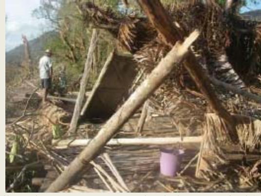
Vollständig zerstörte Gemeindeschule von Ambodiforaha
