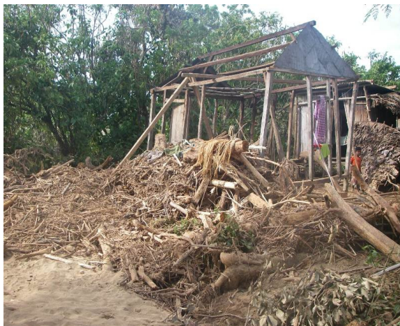
Zerstörtes Wohnhaus mit vom Hochwasser angeschwemmten Trümmern
